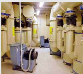
▲市役所西館の空気浄化ユニット
