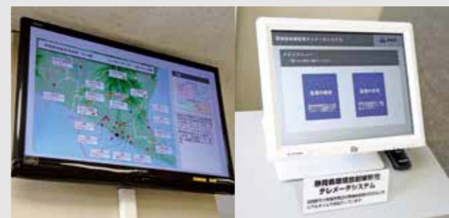
環境放射線監視テレメータシステム表示装置(本庁1階ロビー)
