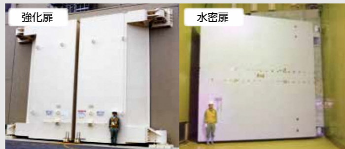
建屋内への浸水を防止する強化扉・水密扉
