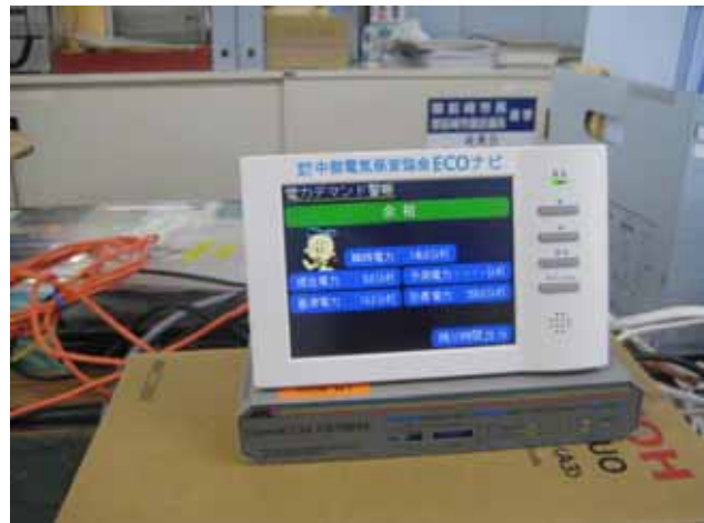
電力デマンド監視装置(総務課内)
