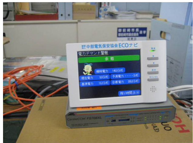
電力デマンド監視装置（財政課内）
