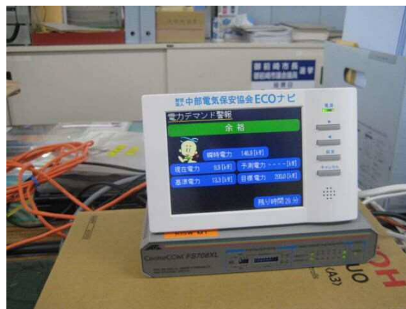
電力デマンド監視装置(財政課内)
