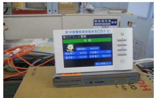
電力デマンド監視装置(財政課内)
