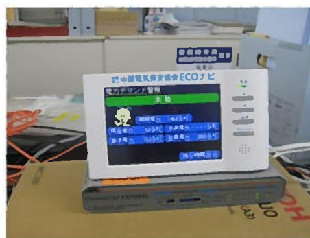
電力デマンド監視装置(財政課内)
