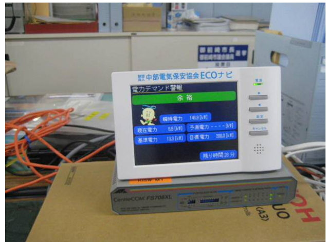
電力デマンド監視装置 (総務課内)
