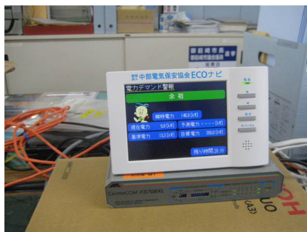
電力デマンド監視装置（財政課内）
