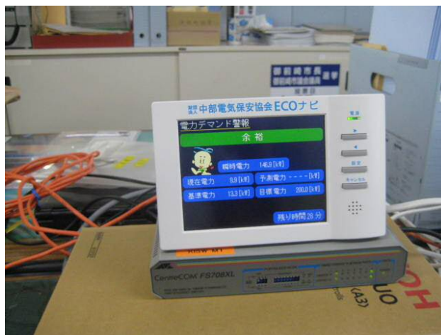
電力デマンド監視装置（財政課内）
