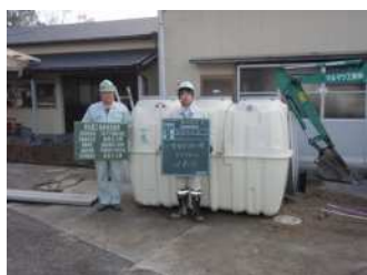
浄化槽本体 設備土
