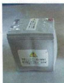
変形したバッテリー
