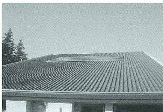
太陽光発電システム
