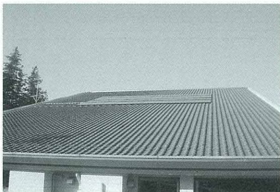
太陽光発電システム
