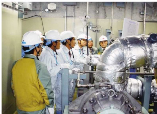
▲3号機漏えい現場の確認
