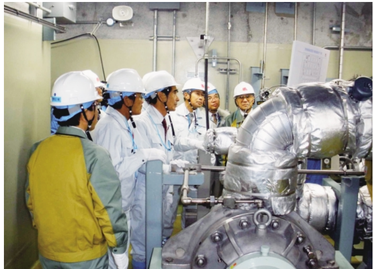
3号機漏えい現場の確認
