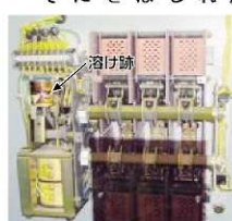
外観点検 制御用電磁コイル2基の被覆等に 変色と溶け跡を確認しました。
