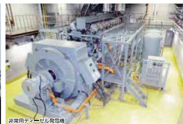
非常用ディーゼル発電機
