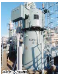
海水ポンプ電動機
