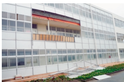
台風15号による被害状況現地視察(10月4日) 視察場所 浜岡中学校
