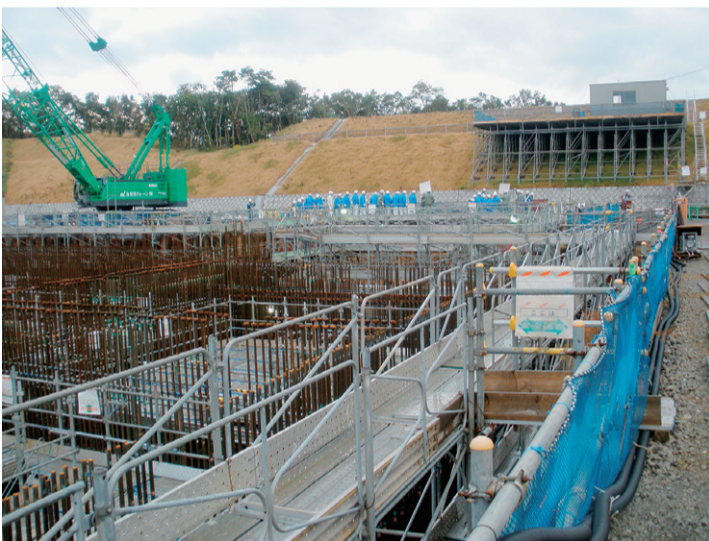
高台への地下水槽建設工事 (中部電力株式会社より提供)
