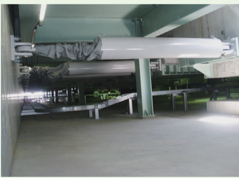
オイルダンパー 32本 (建物の揺れを減衰させる設備) 長さ：約4.5m 直径：約0.4m
