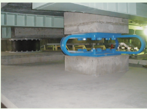
免震ゴムなど(積層ゴム、鋼材ダンパー)
