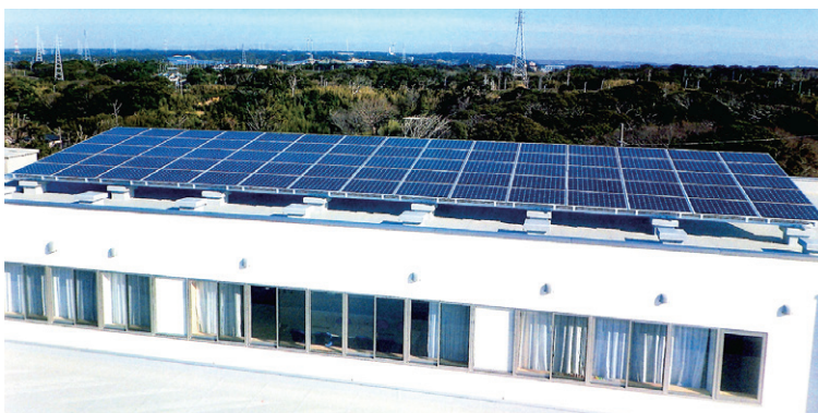
家庭医療センターしろわクリニック設置の太陽光発電パネル
