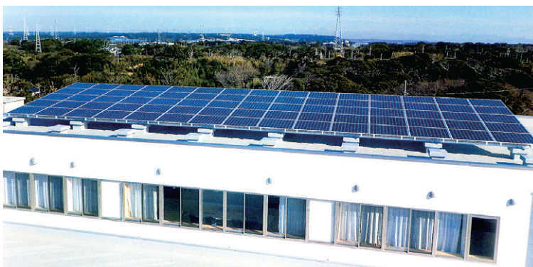
家庭医療センターしろわクリニク設置の太陽光発電パネル
