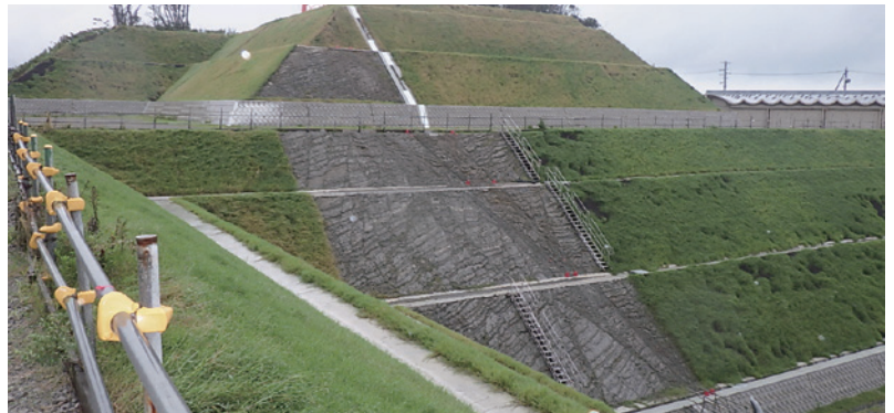
浜岡原子力発電所敷地内にある H-5 断層の露頭
