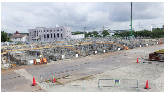
御前崎市新学校給食センター建設工事（8月31日現在） 地下ピット土間コンクリート打設終了、地中梁鉄筋工事施工中【東から西を望む】
