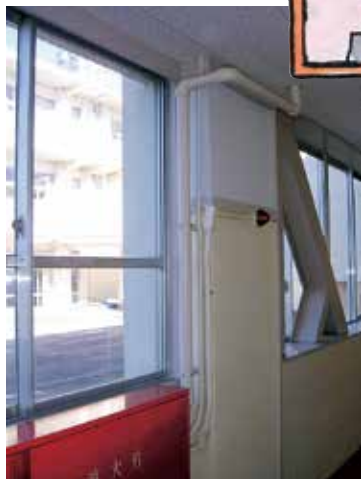
消火せんへつながる水道管
