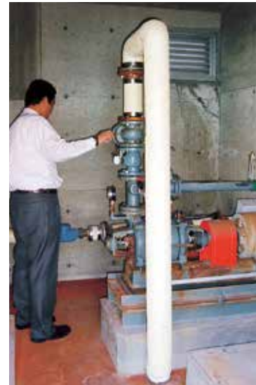
上に水を上げるポンプ室
