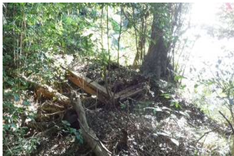
3 橋梁部①崩落箇所復旧工事着手前
