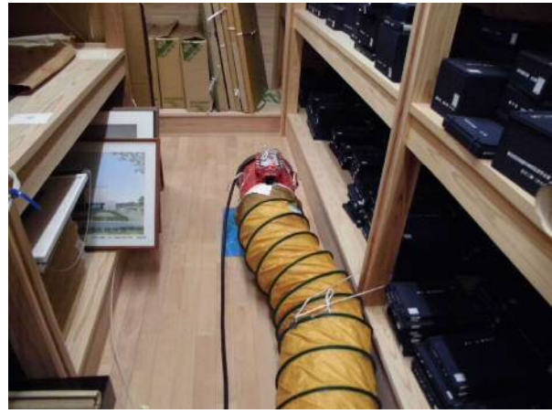
2 防暴型排気ファンの設置(収蔵庫)
