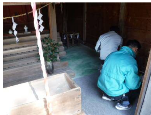
写真 20 岩地正八幡神社本殿の蟻害・腐朽検査の写真
