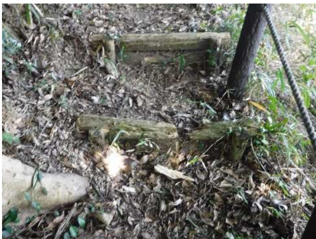
写真10 遊歩道階段丸太横木損傷状況1
