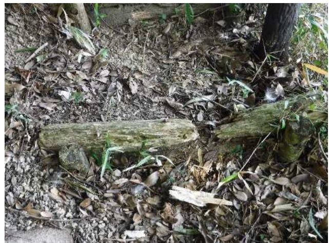
写真11 遊歩道階段丸太横木損傷状況2
