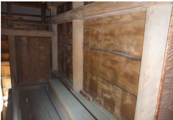
写真24 本殿回廊床の損傷状況2
