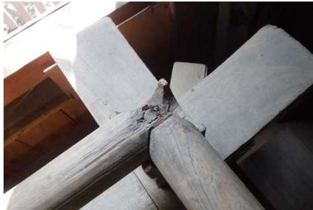
写真 27 本殿回廊ほこぎの損傷状況
