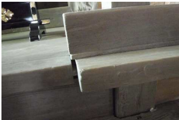
写真 26 本殿框の損傷
