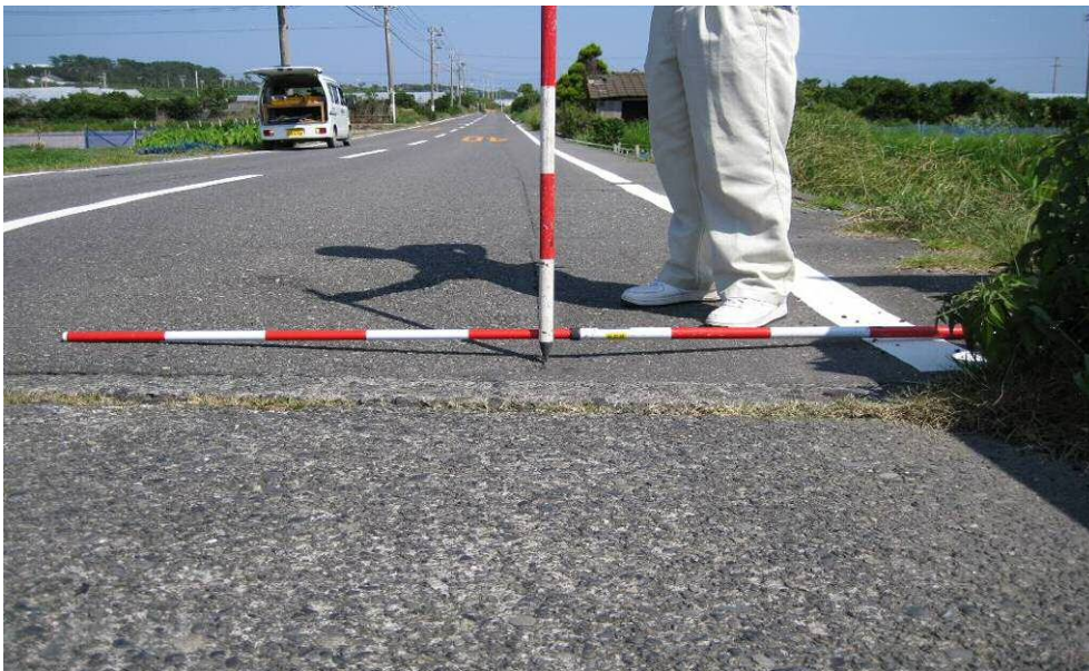
道路パトロールにより舗装損傷箇所発見
