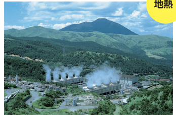
八丁原（はっちょうばる）地熱発電所（※2）
