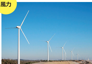
御前崎風力発電所 (※1)
