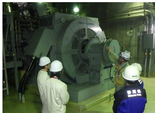
非常用ディーゼル発電機を 確認している様子
