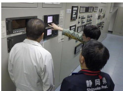
放射線モニタの指示計を確認している様子
